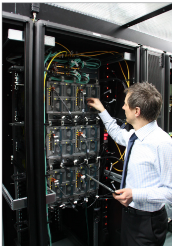
Einblick in das Rechenzentrum der Stadtwerke Schwäbisch Hall
